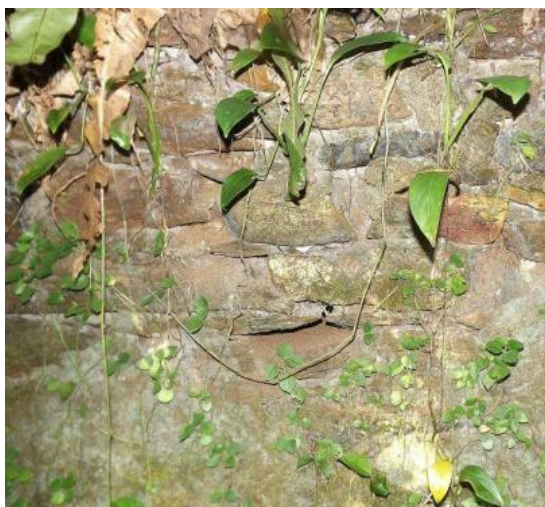
Figura 26. Muro lateral semi-destruído.
