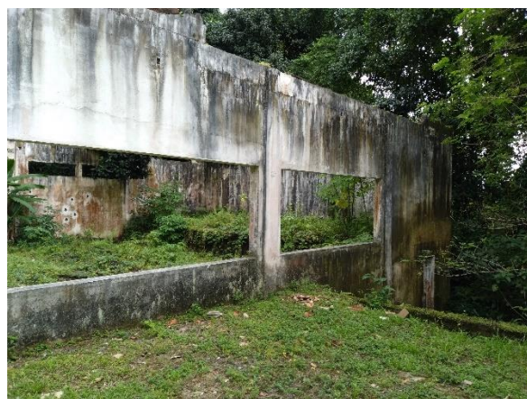
Figura 4-25: Aspecto da edificação em ruínas
