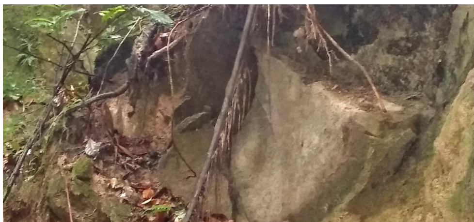
Figura 3-11: Bloco rochoso que sofreu escorregamento translacional, subida do morro do Cristo
